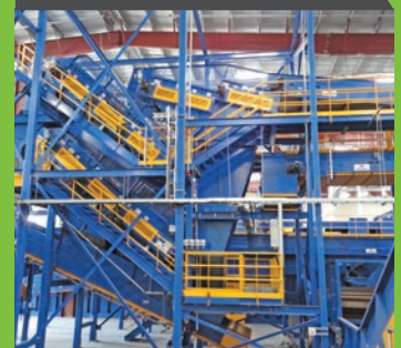
CRIBLE SCALPEUR AU-DESSUS D'UN CRIBLE À JOURNAUX
